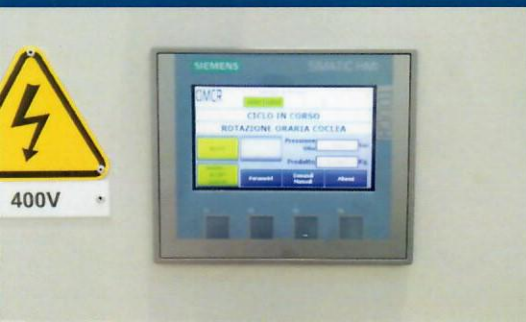
Pannello di controllo Siemens
